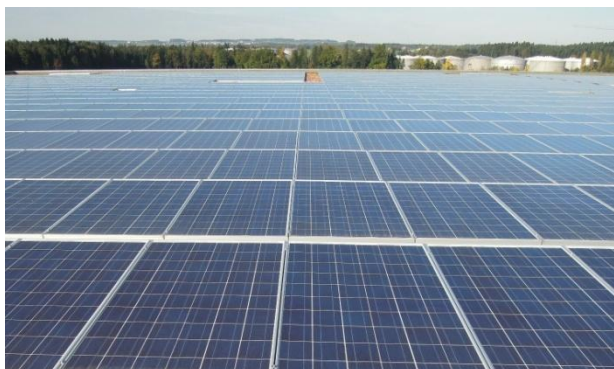
849 kW-Anlage Pistor in Rothenburg
