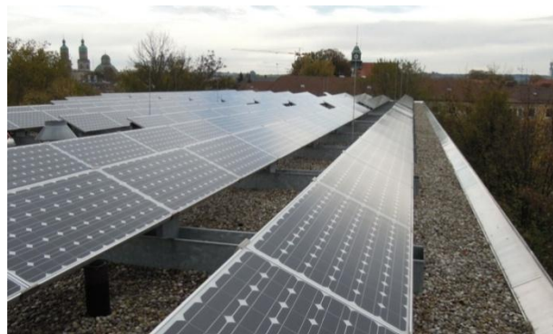
38 kW-Anlage Realschule Hofmühle in Kempten
